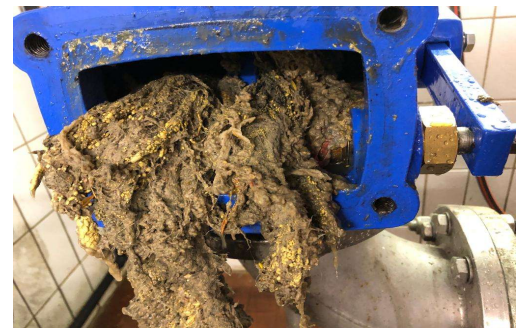
Durch Feuchttücher verstopfte Pumpstation in der Straße Hellgrund
